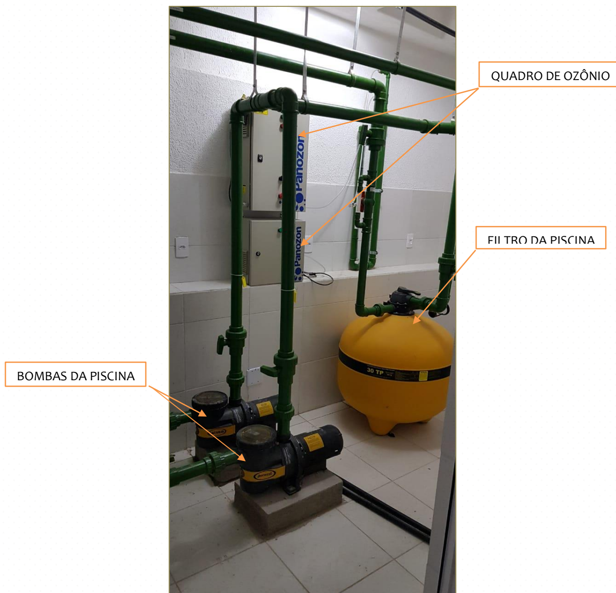
Imagens 01: sistema de tratamento de água e filtro piscina.
