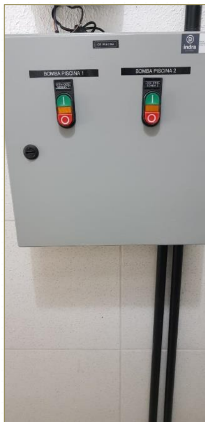
Imagem 03: quadro de controle de bombas da piscina.
