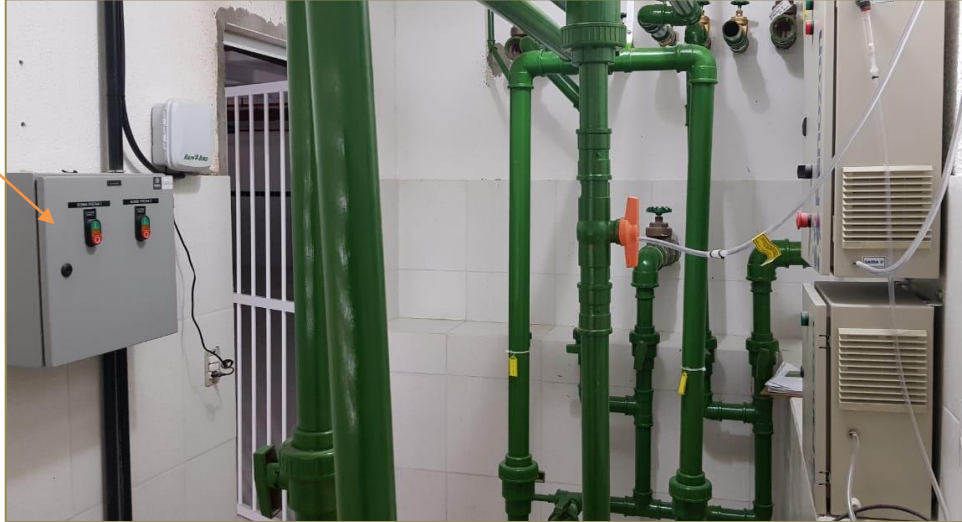
Imagem 02: sistema de bombas e quadros de comando piscina.
