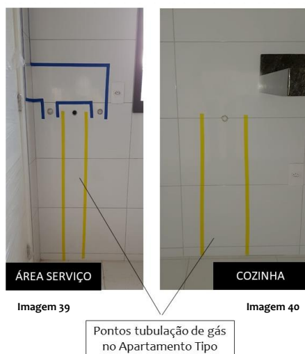
Imagem 39 e 40: Fotos dos pontos de gás do Pavimento Tipo - Coluna 02.
