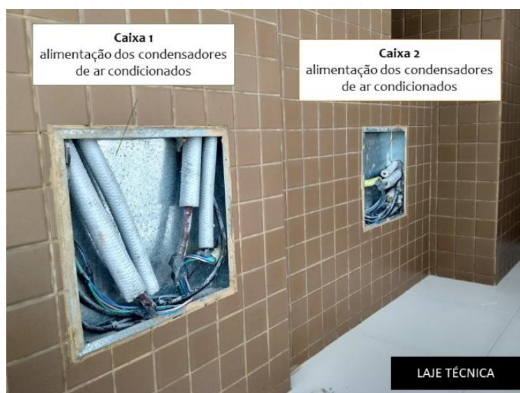
Imagem 37: Caixas de alimentação dos condensadores de ar condicionados do Apartamento Tipo localizados na Laje Técnica.
