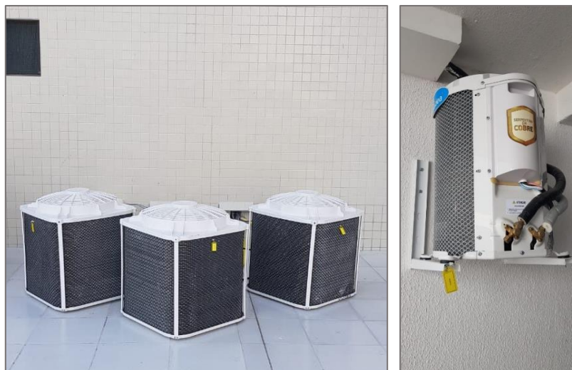
Imagens: localização condensadores de ar-condicionado das Áreas Comuns e da guarita.
