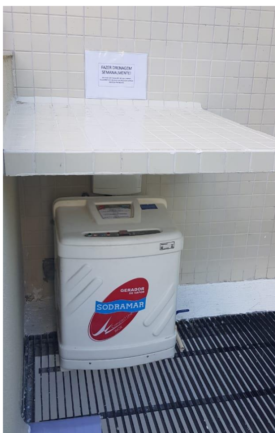
Imagem: Gerador de vapor da sauna.
