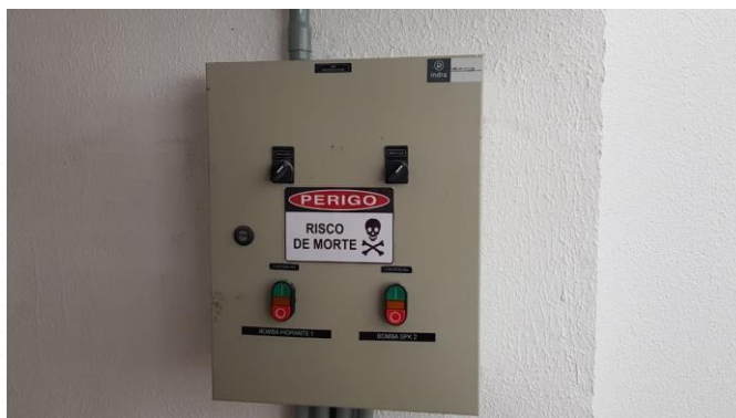
Imagem: quadro controle bombas de incêndio.
