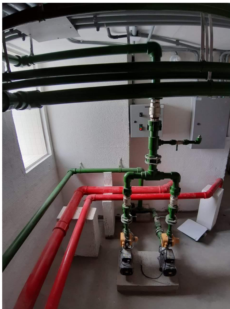
Imagem: Bombas de pressurização de água das coberturas.
