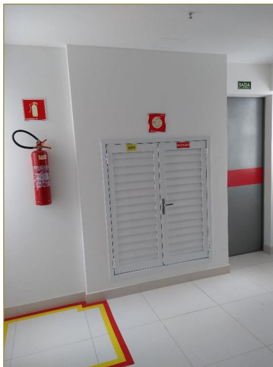
Imagem: Localização de extintores nos halls dos apartamentos tipos.
